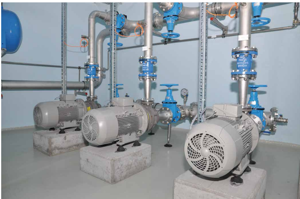
Neue Anlage mit redundant ausgelegten Pumpen und erneuerter Verrohrung. Foto: Stefan Hartmann, Presseladen.
