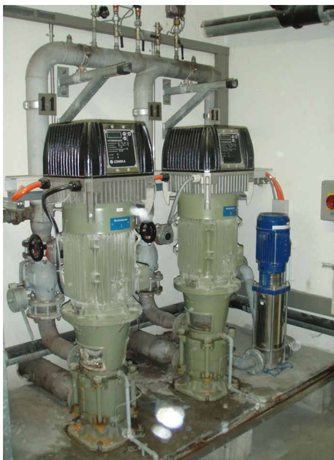
Alte Druckerhöhungsanlage mit 2x Häny 4504/3 Pumpen (Bj. 1992) und 1x Lowara SV808 zur Druckhaltung (Bj. 2001)
