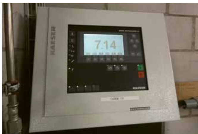
Nouvelle commande en amont des trois compresseurs frigorifiques
