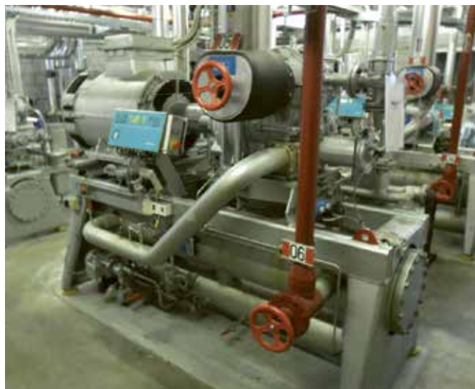
Compresseur frigorifique existant
