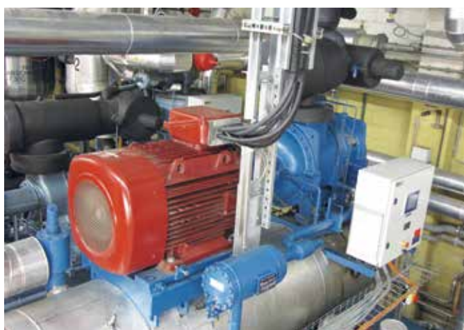
Moteur à aimants permanents avec compresseur à ammoniac
