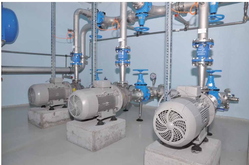
Nouvelle usine avec installation redondante de pompes et tuyauterie rénovée. Photo: Stefan Hartmann, Presseladen.
