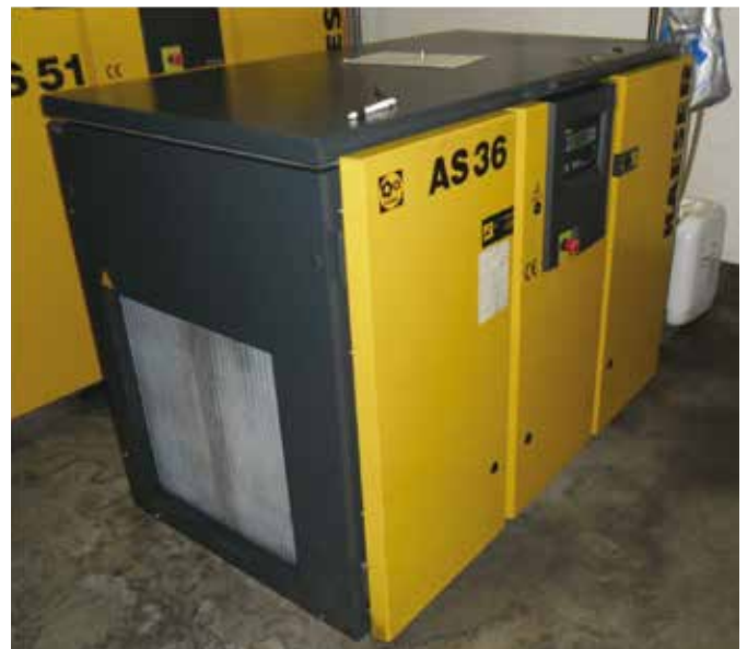
Akustisch gekapselter Druckluftkompressor
