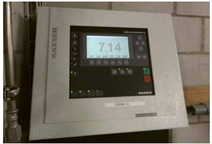
Neue übergeordnete Steuerung der drei Druckluftkompressoren
