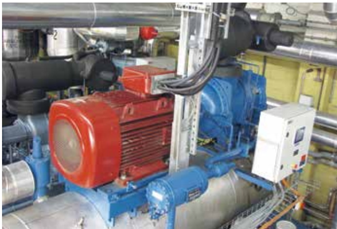
Permanentmagnet Motor mit Ammoniakverdichter
