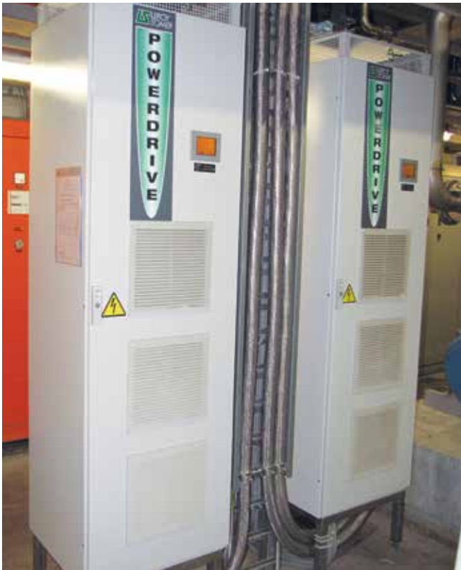
Schaltschrank mit Frequenzumrichter
