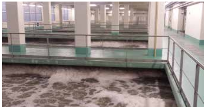
20 Belüftungsbecken zur biologischen Reinigung
