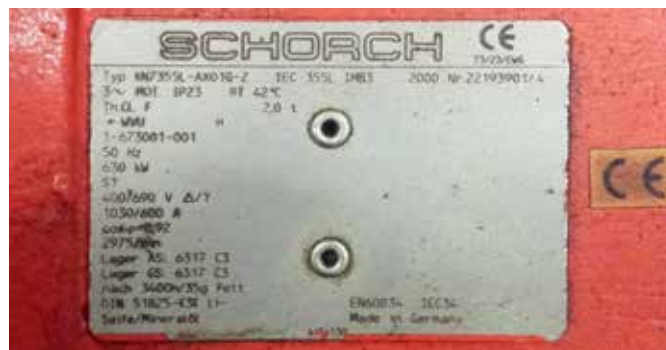
Motor zum Antrieb des Kompressors: Schorch, Baujahr 2000, 630 kW, 2 Pole, 2 975 Umdrehungen pro Minute, Dauerbetrieb S1, cos φ 0,92
