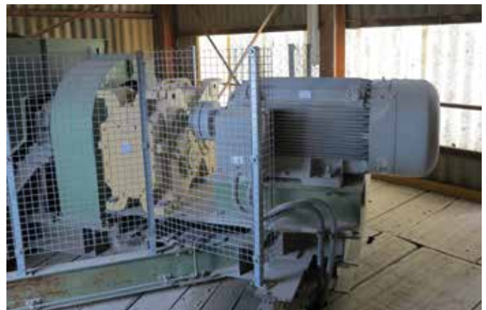
Der neue Motor in Betrieb
