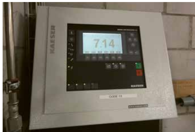
Nouvelle commande en amont des trois compresseurs d'air
