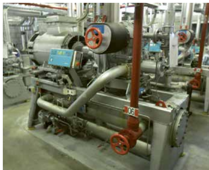
Compresseur frigorifique existant
