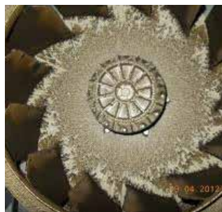
Abbildung 11: Der Gebrauch verschmutzter Ventilatoren vermindert Luftvolumenstrom und vergrössert den Energieverbrauch
