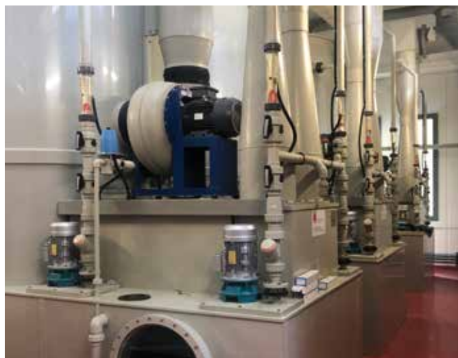
Die Abluftreinigungsanlage heute. Foto: PAMP
