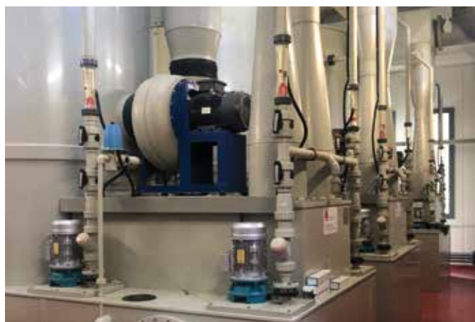
L'installation d'épuration des émissions gazeuses aujourd'hui. Photo: PAMP
