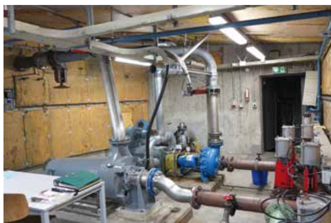
Die Pumpstation mit den beiden Klärschlamm-pumpen. Foto: Topmotors
