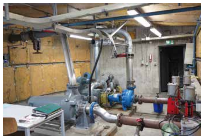
La station de pompage avec les deux pompes à boues. Photo: Topmotors
