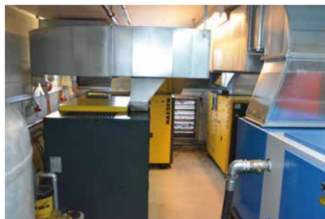
Vier alte Kompressoren im älteren Technikraum.
