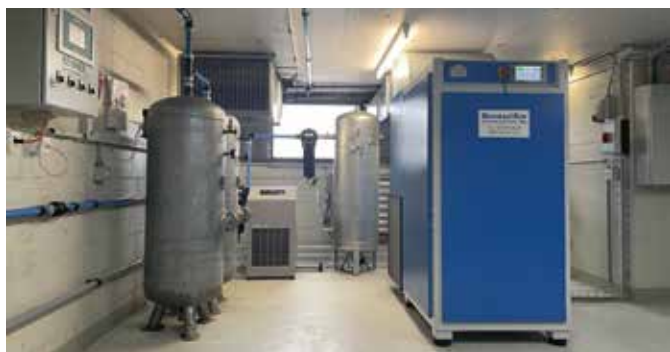
Derselbe Technikraum, mit nur einem neuen Kompressor. Foto: Michael Broccard, Schrad'air Compresseurs SA
