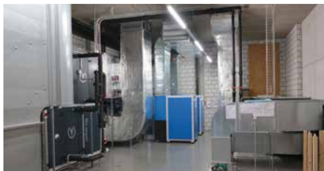
Zwei neue Kompressoren im geräumigen Lufttechnikraum. Foto: Márton Varga, Topmotors
