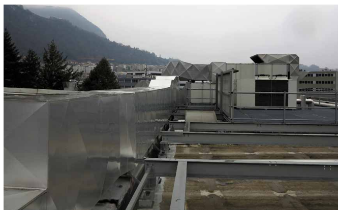
Lüftungsanlage auf dem Dach. Foto: Márton Varga, Topmotors
