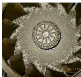
Figura 11: l'uso di ventilatori sporchi riduce la portata e aumenta il consumo energetico
